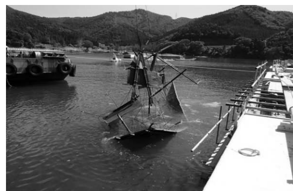
写真-5 被災状況
